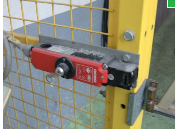
▲ Ejemplo de dispositivo de enclavamiento en puerta del vallado perimetral
