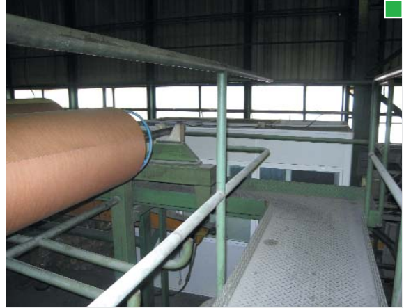
▲ Pasarela protegida con barandilla en zona superior de una embaladora, en donde se encuentran las bobinas de papel de embalaje
