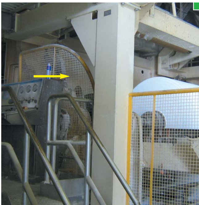
▲ Ejemplo de protección de la línea de contacto por el lado conductor
