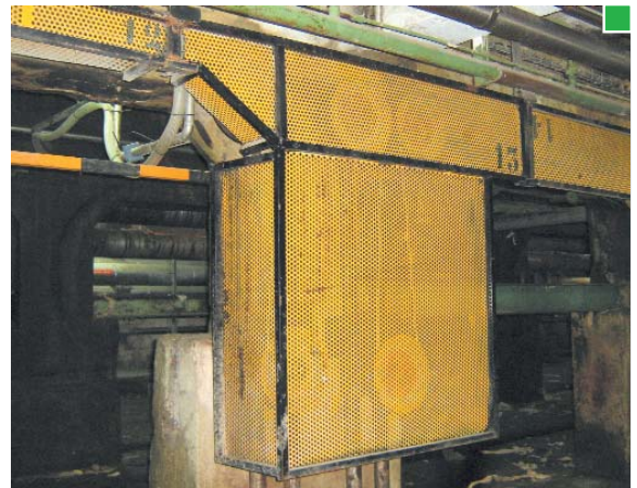
▲ Resguardo fijo, que protege además del riesgo de golpe por rotura de la cuerda (ver apartado de: Golpes por roturas de cuerdas)
