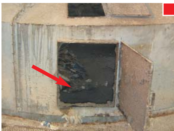
▲ Compuerta de acceso para personas al interior del púlper
