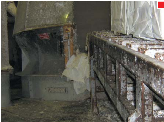
▲ Vista de cintas sin protecciones laterales que retengan la carga que transportan
