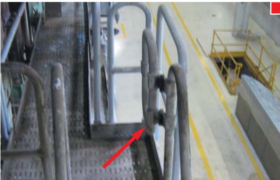
▲ Dispositivo de cierre deteriorado
