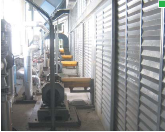
▲ Resguardos fijos tipo chapa en transmisiones
