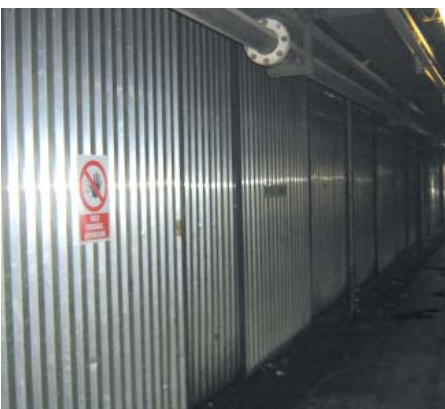
▲ Vista de galería en sótano de máquina
