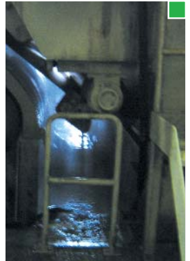
▲ Protección con barandilla en hueco que permite el paso de personas
