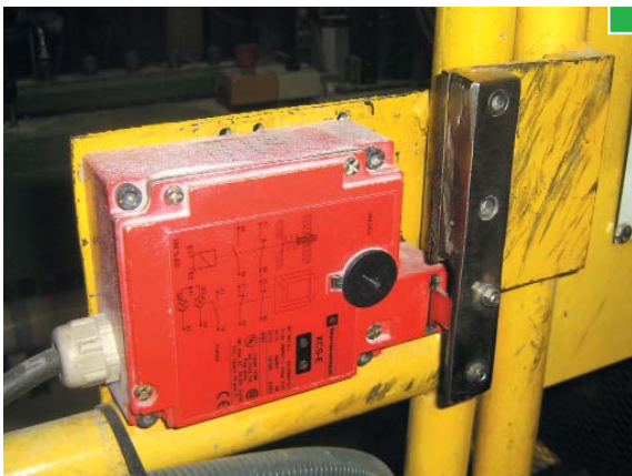
▲ Dispositivo de enclavamiento en la puerta de acceso al interior del apilador. Su apertura provoca el paro del equipo
