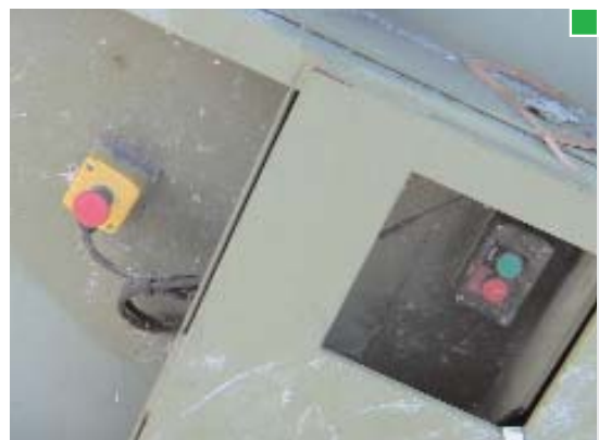
▲ Las paradas de emergencia deben ser fácilmente accionables y accesibles desde el lugar de operación
