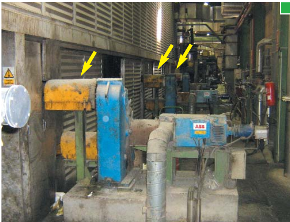
▲ Todas las zonas accesibles de las transmisiones deben estar protegidas
