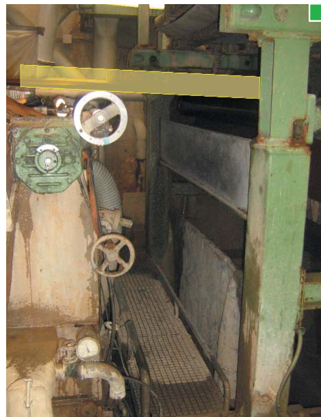
▲ Debe protegerse la zona lateral del fieltro mediante resguardos fijos
