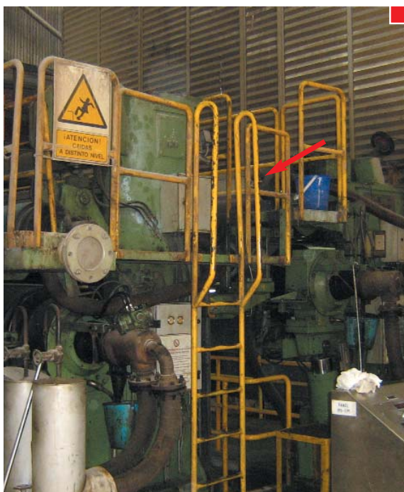
▲ Escala vertical que no cumple los requisitos (falta puerta entre plataforma y escala)
