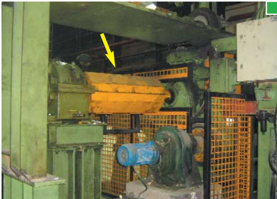
▲ Vista de protecciones por el lado transmisión en una enrolladora
