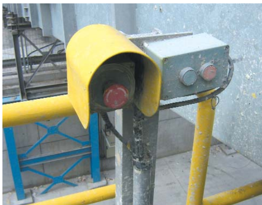
▲ Envoltente en torno a dispositivo de paro de emergencia. Es una posible solución para evitar la acumulación de suciedad en estos dispositivos y permite acceso al mismo.
