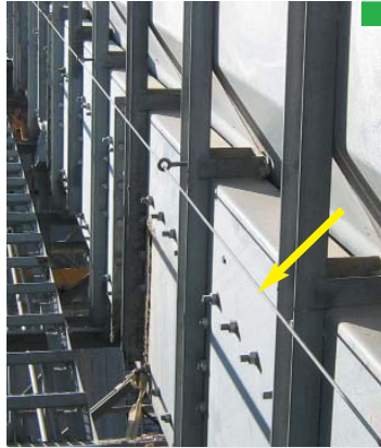
▲ Detalle del cable de paro de emergencia
