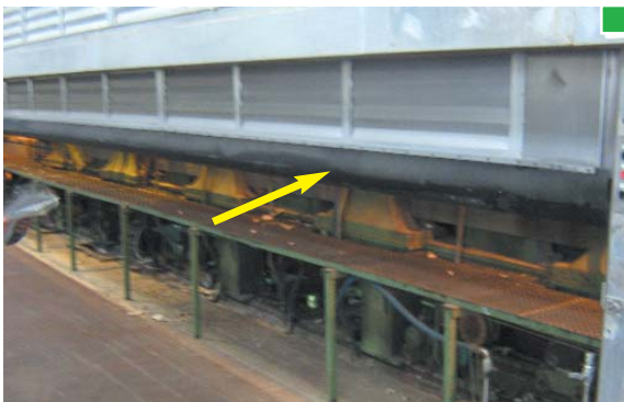
▲ Puerta con dispositivo sensible de detección mecánica, en el borde inferior
