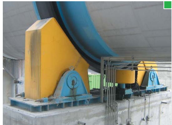
▲ Se debe crear una envolvente en torno a la zona peligrosa, de forma que sea inaccesible
