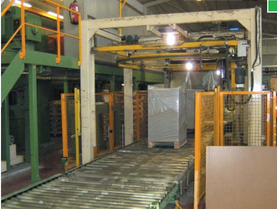
▲ Ejemplo de vallado perimetral de la zona de embalaje
