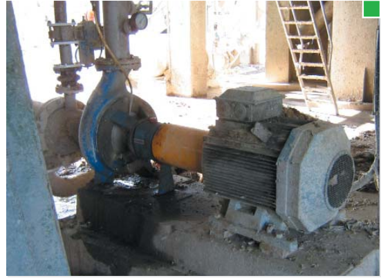
▲ Protección en árbol de transmisión de bomba
