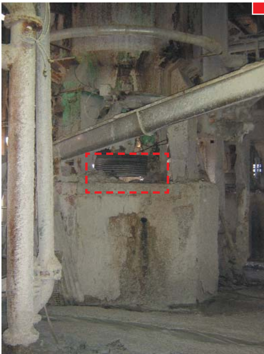
▲ Correas de transmisión al eje de la hélice. La base de hormigón hace inaccesibles los puntos de atrapamiento pero existe peligro de "latigazo" con las correas en caso de rotura
