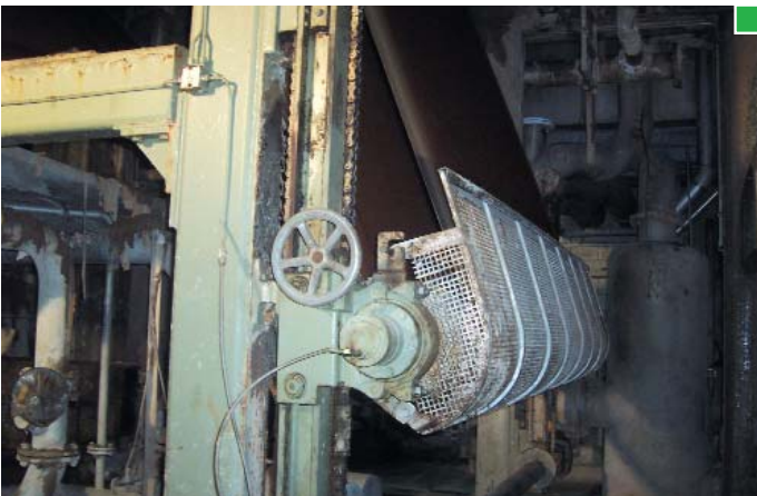
▲ Ejemplo de protección fija a todo lo ancho de la máquina
