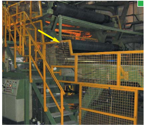
▲ Protecciones con altura correcta.
