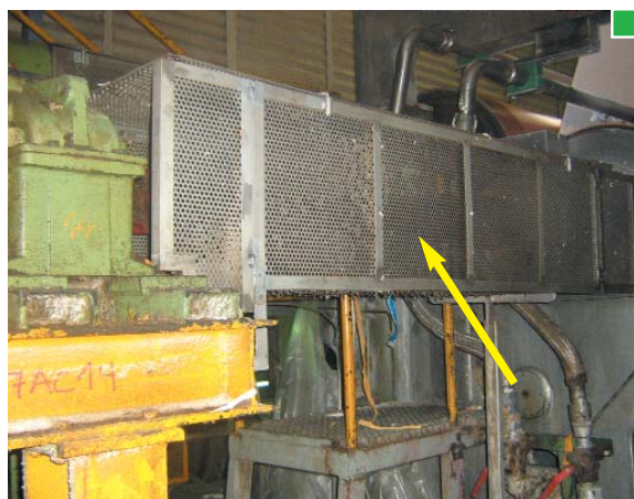
▲ Resguardo fijo tipo rejilla, luz de malla en función de la distancia a la zona peligrosa
