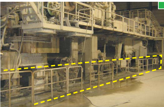
▲ Protección fijada al suelo
