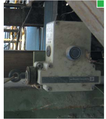
▲ Detalle del dispositivo de paro de emergencia
