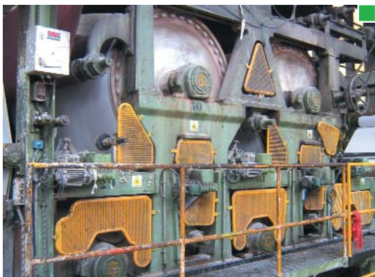
▲ Elementos móviles que intervienen en el trabajo protegidos mediante resguardos fijos
