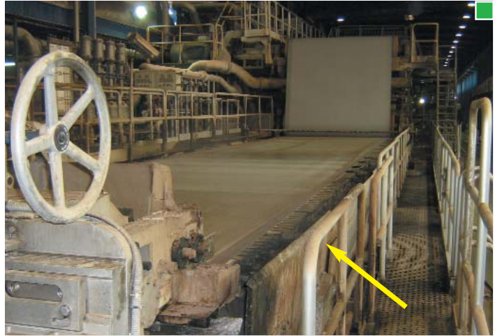
▲ Instalar barandillas con rejilla para impedir el posible contacto con la tela
