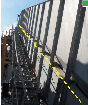
▲ Pasarela en cinta transportadora de alimentación
