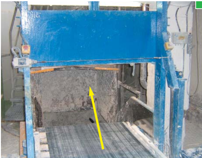
▲ Cinta transportadora de alimentación. Zona boca de entrada en púlper. Cable de emergencia y setas de emergencia, una en cada lado
