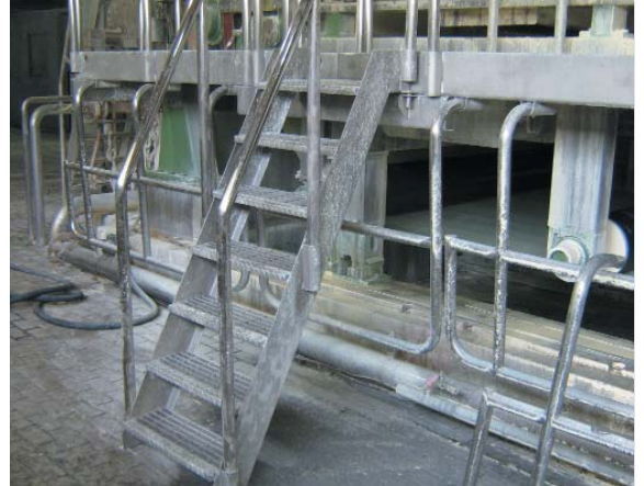
▲ Escaleras de servicio según R.D. 486/97
