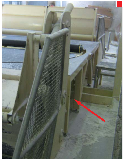
▲ Debe cerrarse el perímetro de la embaladora también en la parte inferior si los elementos móviles son accesibles
