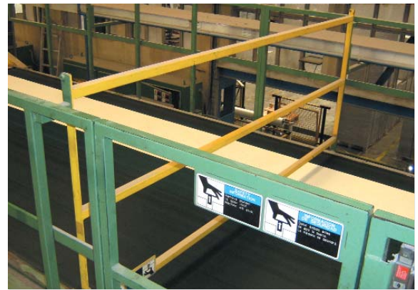
▲ Puerta asociada a dispositivo de enclavamiento cuya apertura provoca el paro de la cortadora. El dispositivo o valla amarilla (giratoria sobre eje horizontal) para la cortadora si una persona viene sobre la cinta por caída u otras causas
