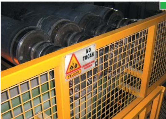
▲ Ejemplo de resguardo para evitar el acceso a la zona de atrapamiento
