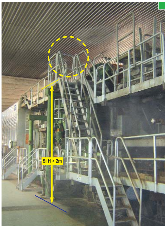
▲ Proteger lado abierto si la altura es superior a 2 m.
