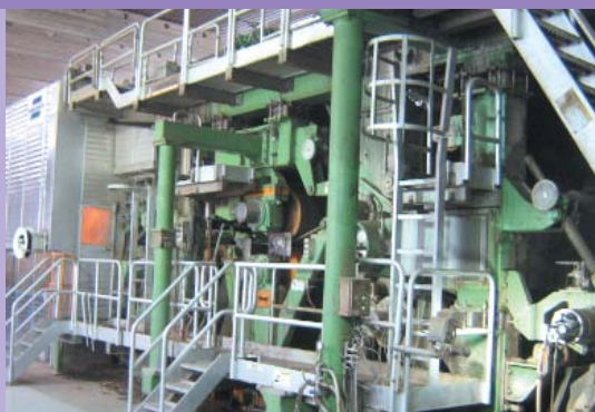
▲ Vista general de la sección de prensas
