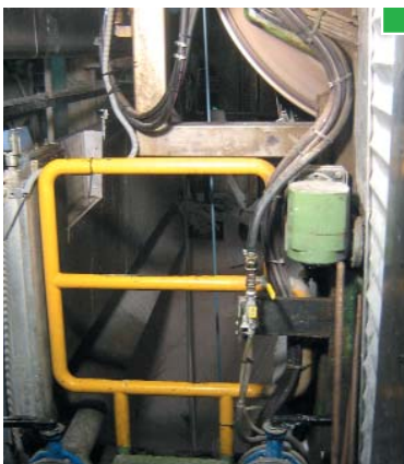
▲ Protección en hueco con peligro de caída al púlper
