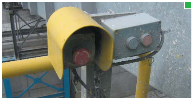
▲ Envolvente en torno a dispositivo de paro de emergencia. Es una posible solución para evitar la acumulación de suciedad en estos dispositivos
