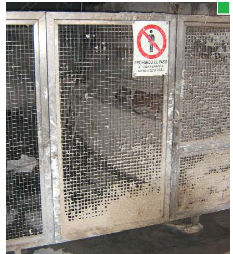
▲ Puerta de acceso. Para su apertura es necesario el uso de llave
