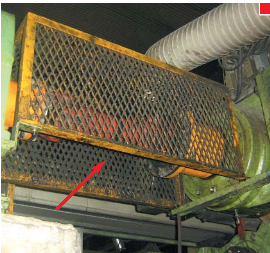
▲ Los resguardos deben crear una envolvente entorno a la transmisión (falta rejilla en la parte inferior de la protección)
