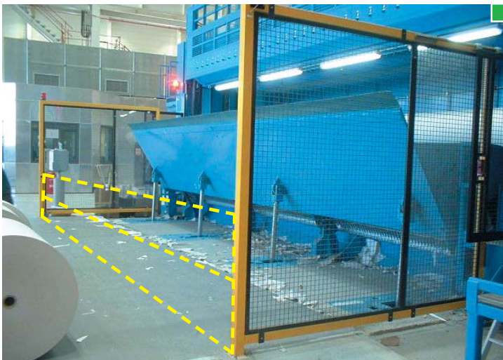
◀ Laterales de la cuna protegidos con resguardo fijo. Zona frontal con barrera fotoeléctrica que se activa con la cuna en movimiento
