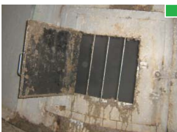
◀ Compuerta de acceso para mantenimiento con ventana de inspección
