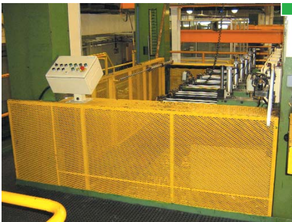
▲ Perímetro en torno al apilador (zona superior) protegido mediante resguardo fijo
