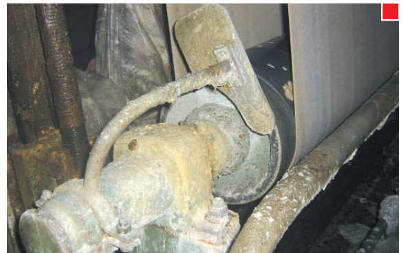
▲ Resguardo fijo que no impide el acceso a zona de atrapamiento.
