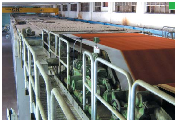
▲ Una solución es colocar barandillas abatibles o plegables. Cuando se realicen trabajos en la zona deben levantarse tales protecciones, siguiendo un procedimiento específico en condiciones de trabajo seguras
