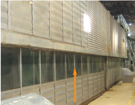
▲ Existe riesgo de golpe o atrapamiento con las puertas de acceso al interior de la campana
