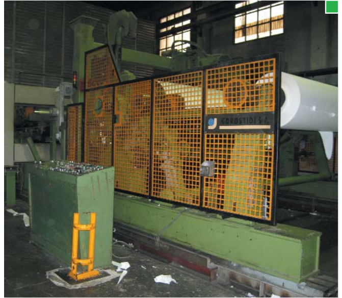
▲ Protección lateral. Las dimensiones del resguardo, la distancia a la zona peligrosa y la rejilla empleada hacen inaccesible el punto de atrapamiento
