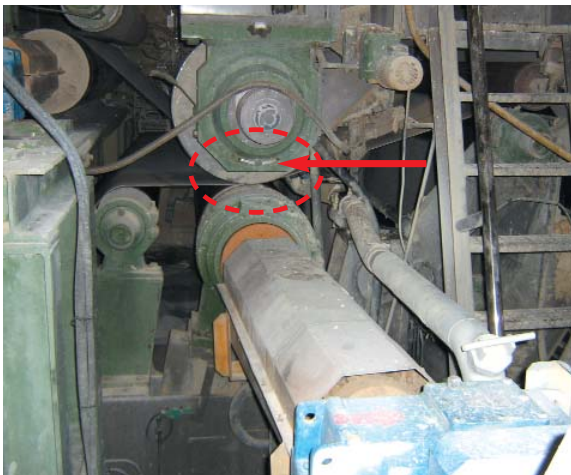
▲ Los nips de prensas deben protegerse de la misma forma que en el lado conductor
