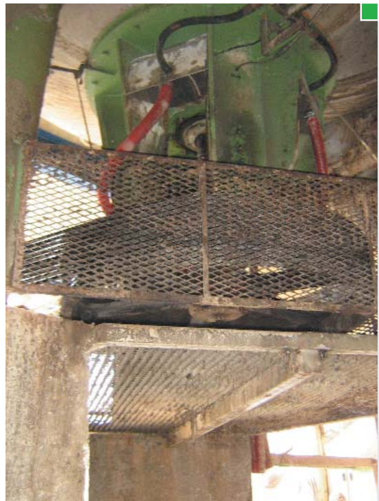
▲ Los resguardos instalados en este ejemplo retienen la correa en el caso que se produzca la rotura
