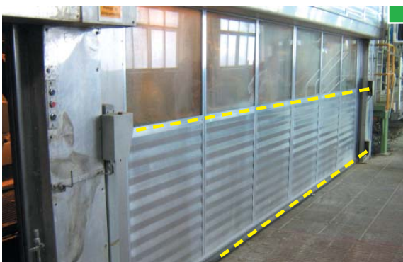
▲ Puerta de sequería con barrera inmaterial mediante células fotoeléctricas. En el caso de interferir el haz (línea discontinua amarilla) la puerta se detiene
