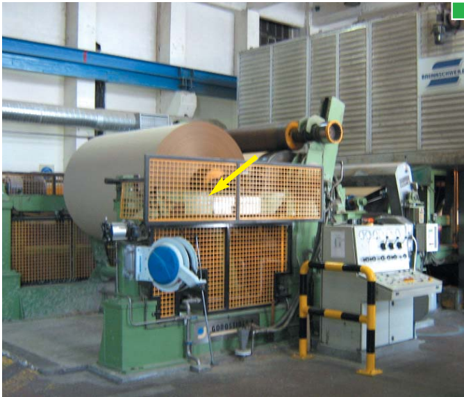
◀ Ejemplo de protecciones laterales mediante resguardo fijo
