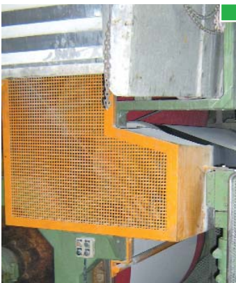
▲ Protección de nips cuerda-polea y protección del recorrido de la cuerda
