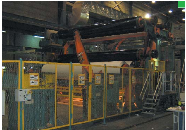
▲ Cuando hay paso directo de la salida de la enrolladora al almacén de rollos se necesita protección lateral que restrinja el acceso a la zona. Si dispone de puertas su apertura debe estar asociada al dispositivo de expulsión del rollo
