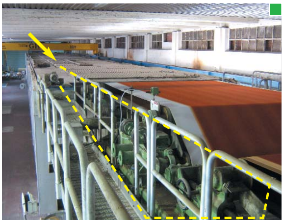
▲ Ejemplo de pasarela con barandilla en torno a fieltros de prensas en la zona superior de la máquina
