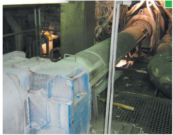
▲ Resguardo fijo tipo rejilla, luz de malla en función de la distancia a la zona peligrosa.
