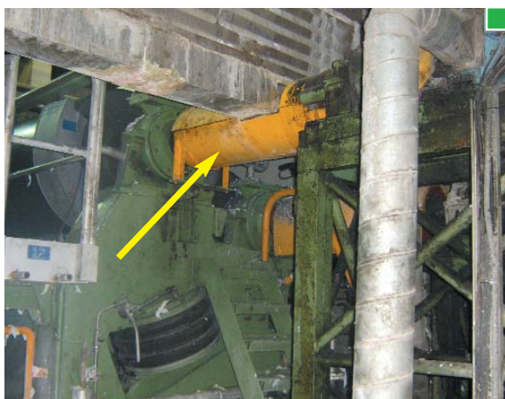
▲ Resguardos fijos en transmisiones
