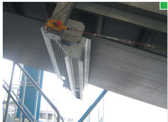
▲ Protección de rodillo en banda inferior de cinta
