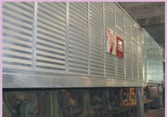
▲ Vista de campana de aspiración
