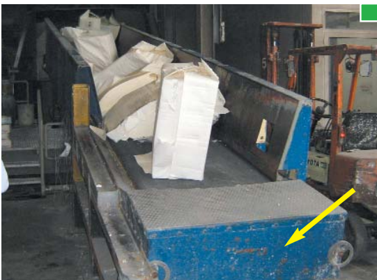
▲ Protección en rodillo motriz de cinta transportadora
