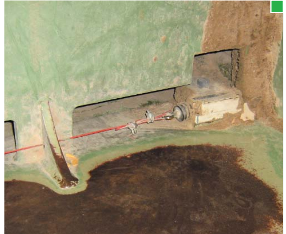
▲ Detalle de dispositivo de cable de emergencia
