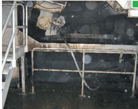
▲ Caída hacia foso protegida mediante barandilla
