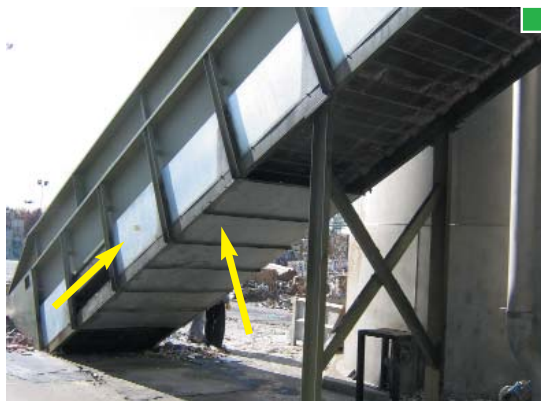
▲ Protección, hasta 2,5 m de altura, de zonas accesibles en cintas transportadoras (lateral e inferior)
