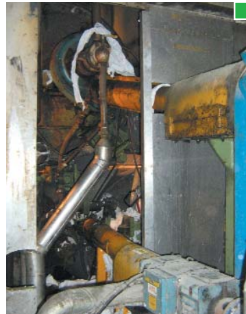
▲ Cardan protegido en el interior de la campana
