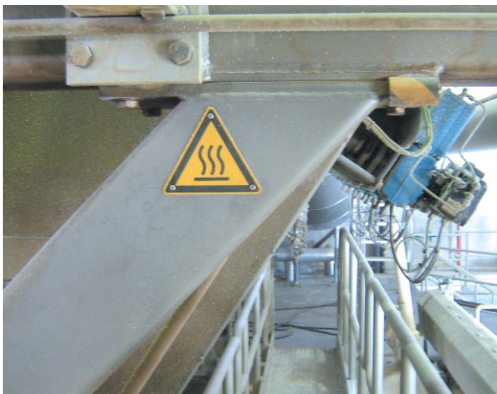
◀ Ejemplo de señalización de superficie caliente
