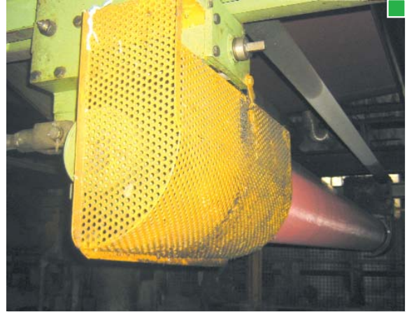
▲ Protección de nip manta-rodillo mediante resguardo fijo
