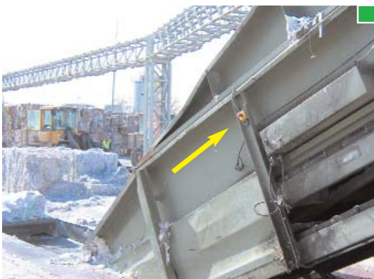
▲ Ejemplo de parada de emergencia en la zona de alimentación de cintas transportadoras
