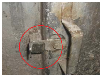
▲ Medida preventiva: asegurar el cierre de la compuerta mediante sistema que necesite de llave o herramienta para su apertura
