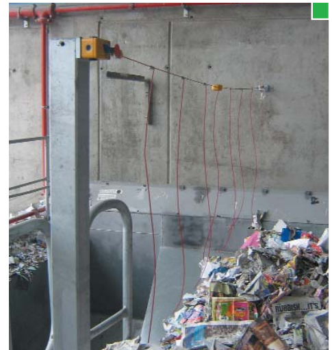
▲ Arco de parada de emergencia en cinta transportadora
